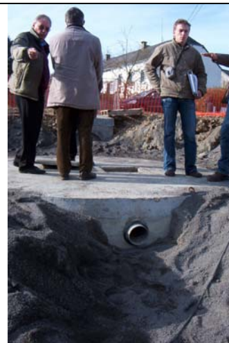
Aval de la fosse septique (F.S., 17 m 3 )
