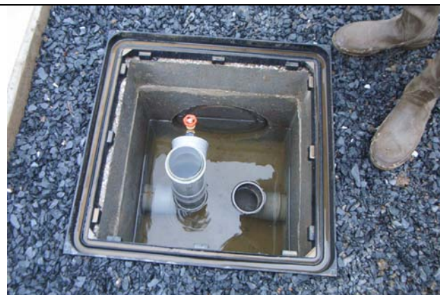
Regard de sortie (g. : tuyau de remontée des eaux sortant d'une cellule, dr. : sortie vers la rivière).
