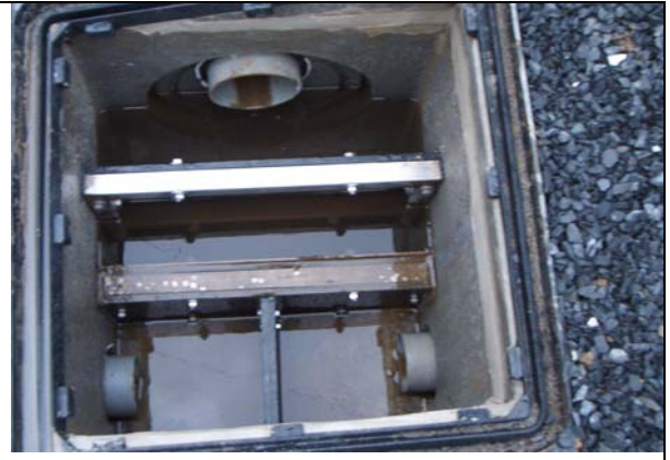
Répartiteur des eaux pour 2 cellules.
